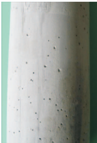
Fot. 1. Makropory powstałe przez inwazję gazu w strukturę wiążącego zaczynu cementowego
