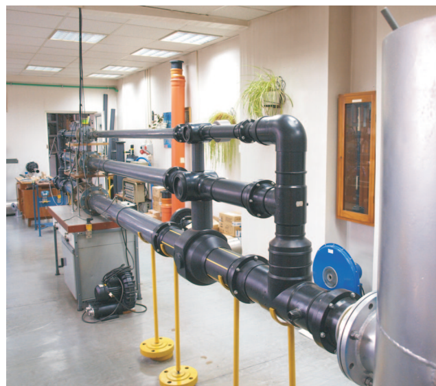
Fot. 1. Stanowisko SGT 1000 do sprawdzania właściwości metrologicznych gazomierzy turbinowych i rotorowych
