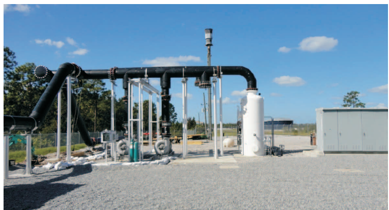
Fot. 5. Dmuchawy odbierające gaz ze składowiska oraz separator wstępny
