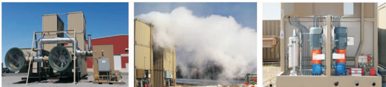
Fot. 1. Układy termiczne (wyparki) stosowane w procesach odsalania wody z wypływu zwrotnego po zabiegach hydraulicznego szczelinowania na złożu Marcellus Shale, oferowane przez firmy: Trilogy i Avara [16]
