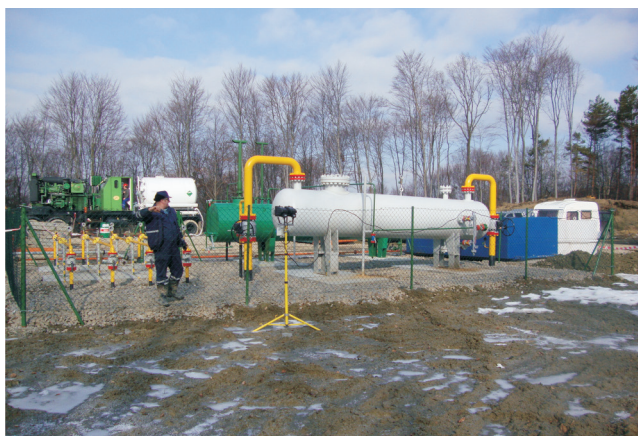
Rys. 4. Urządzenia do testowania odwiertów nr SH5, SH6, SH7 i SH8
