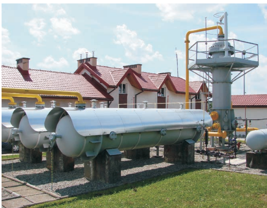
Rys. 3. Osłony termiczne zamontowane na zbiornikach magazynowych glikolu
